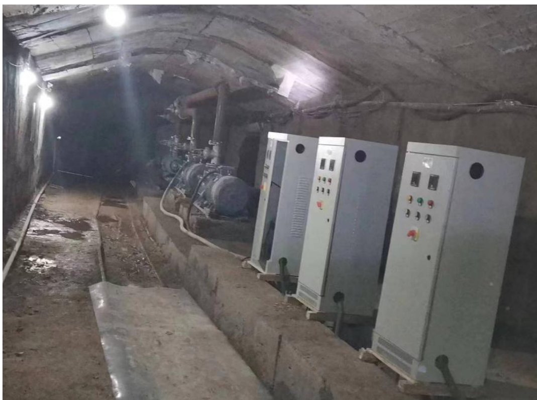
-60m 中段水泵房
